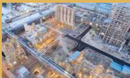
Nella foto sopra: impianto realizzato da MAIRE a Baku, Azerbaijan 2018
